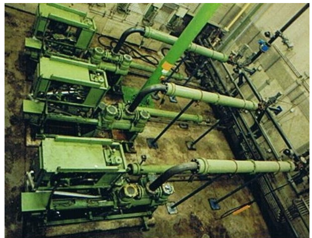
Rohrspeicher in Saug- und Druckleitung von KH-Pumpen
